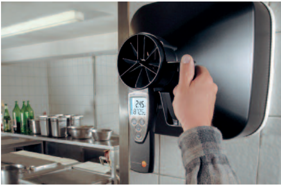
Kontrolle der Abluft an einem Aufputzlüfter
